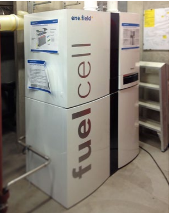
Centre énergétique installé dans le Neobuild Innovation Living Lab
